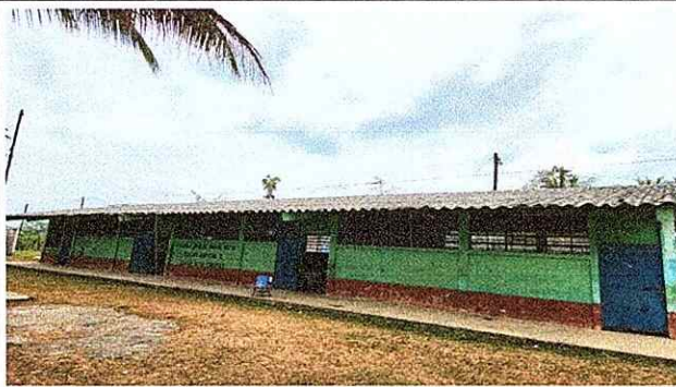
Foto 3: la estructura y cubierta de techo en mal estado
